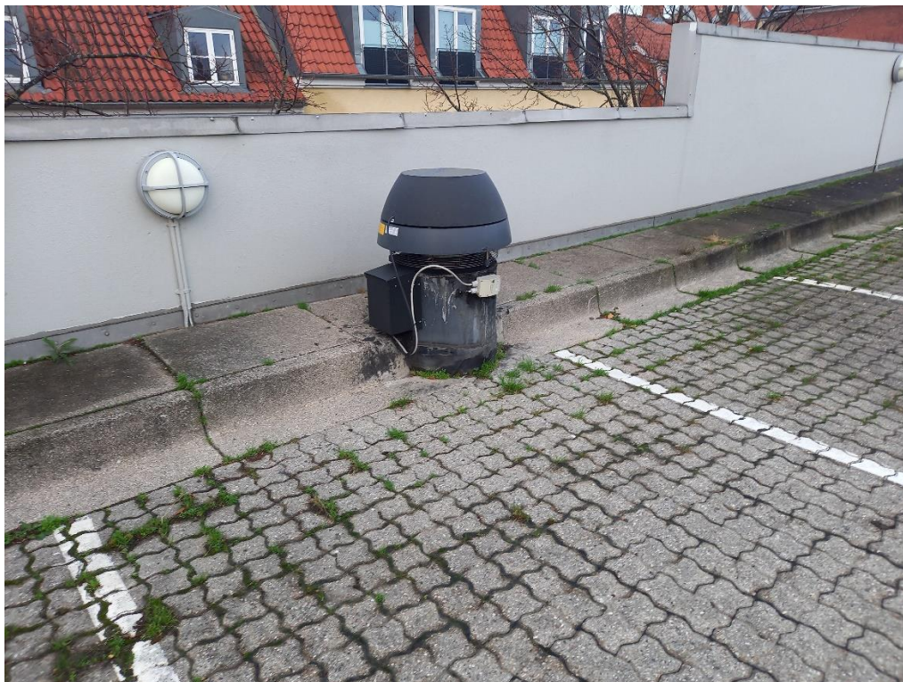
Figur 32 Eksisterende afkast fra erhvervskøkken
